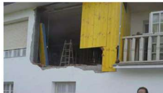
Estado en el que quedó la fachada de la casa de Gandarío. / VÍCTOR ECHAVE
